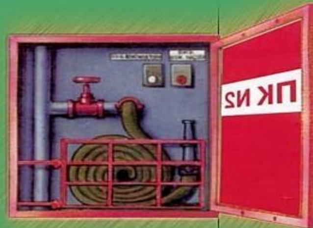
ПОЖАРНЫЙ КРАН В ЗДАНИИ
